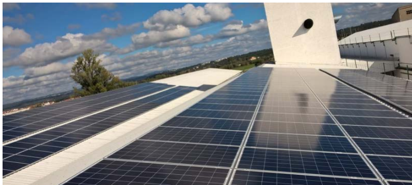
6 – Central Fotovoltaica para Autoconsumo (Fonte: Vivapower Selfenergy)
