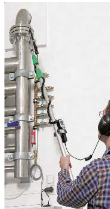
Figura 2 – Detecção de fugas (Fonte: Biaut Automação Industrial)
